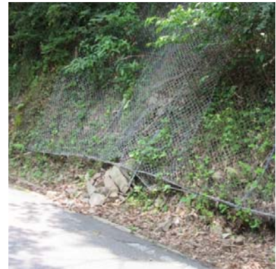
落石防護網裾のこぼれ出し状況
