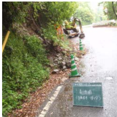
小規模崩壊の状況
