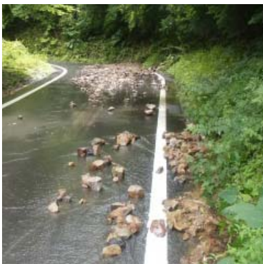
小規模落石の状況
