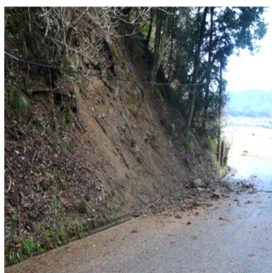
施工前：斜面崩壊
